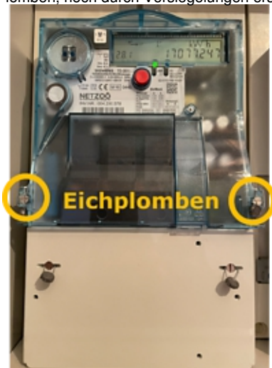
Abb. Eichplombe am Zähler
